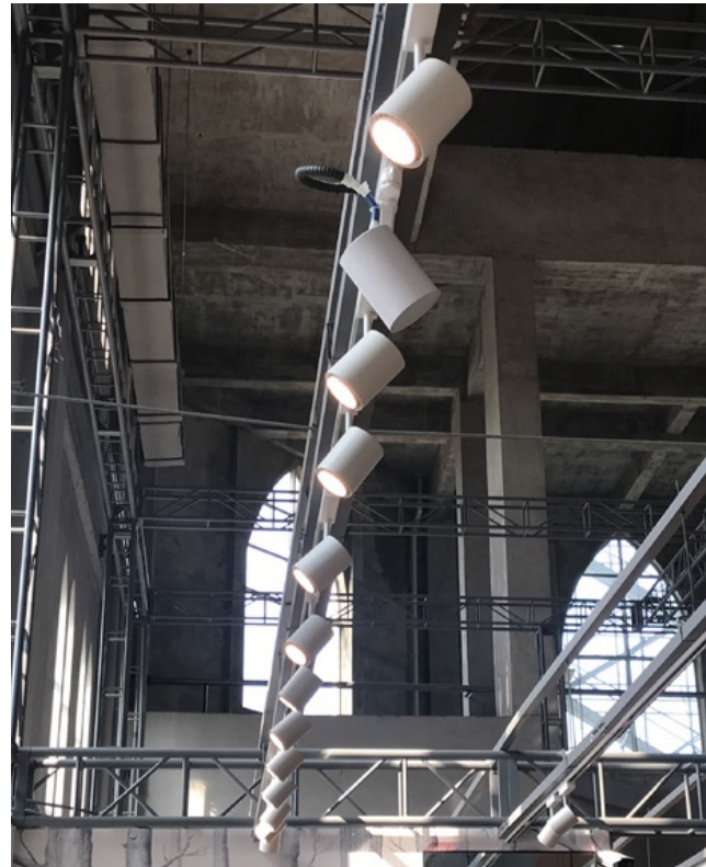
Instalación sobre carriles electrificados
